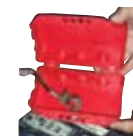
12 Volt DC Starter Batteries
